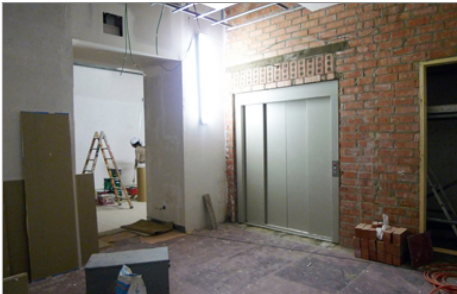
Muntacàrregues ja instal·lat
