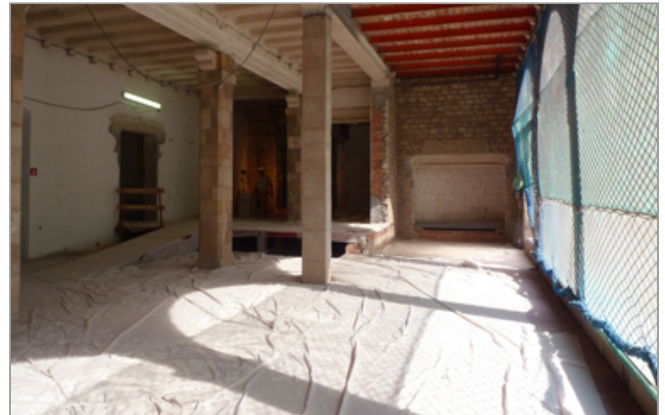
Enderroc del mur de la galeria del primer pis. Sala 15
