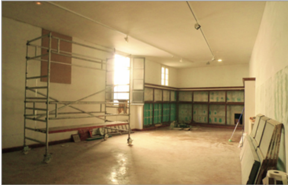
Condicionament i nou muntatge de la Sala de les Armes i la Sala Montserrat
